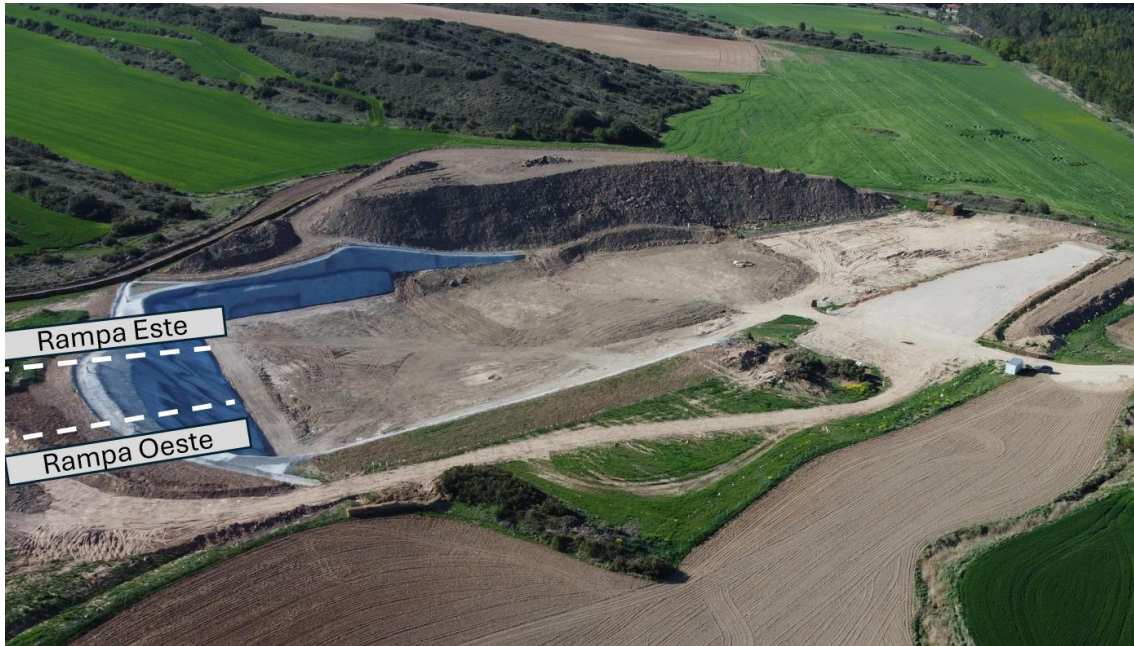
Imagen de las obras preliminares de la bocamina en Undués de Lerda
